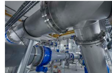
12) Schieber- und Pumpenraum
